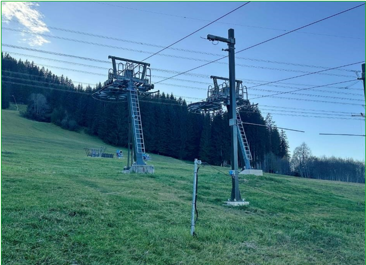
Bild 53: Vereinbarungsgemäß wurden auch die Stützenkonstruktionen mit den Umlenkrollen des Maisiliftes II in der Tarnfarbe RAL 6014 gefärbelt (29.10.2024).
