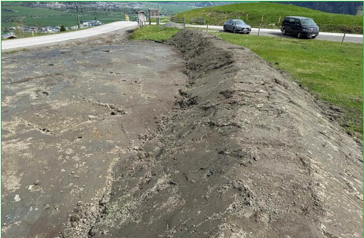
Bild 43: Der abgegrabene Oberboden wurde am Rande des zukünftigen Baubereiches in einer normgemäßen Miete gelagert (11.04.2024).
