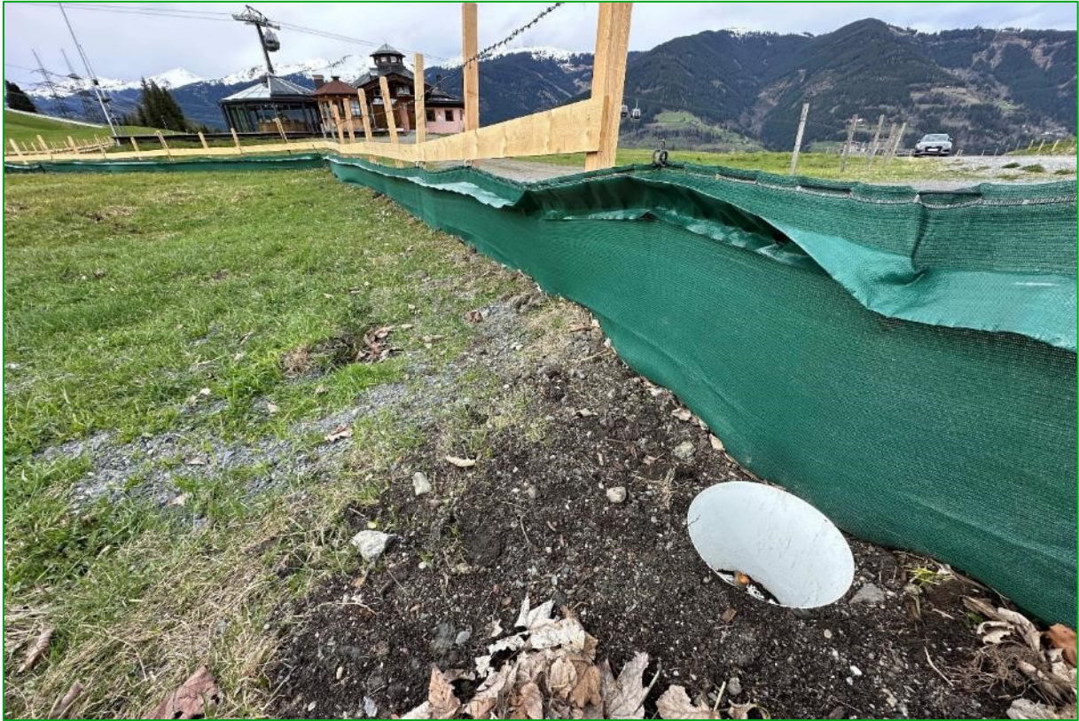
Bild 41: Vorbildlich errichteter Bauzaun mit kombiniertem Amphibienschutzzaun und installiertem Fangkübel auf der Südseite der zukünftigen Baustelle der Schipistenunterführung (04.04.2024).
