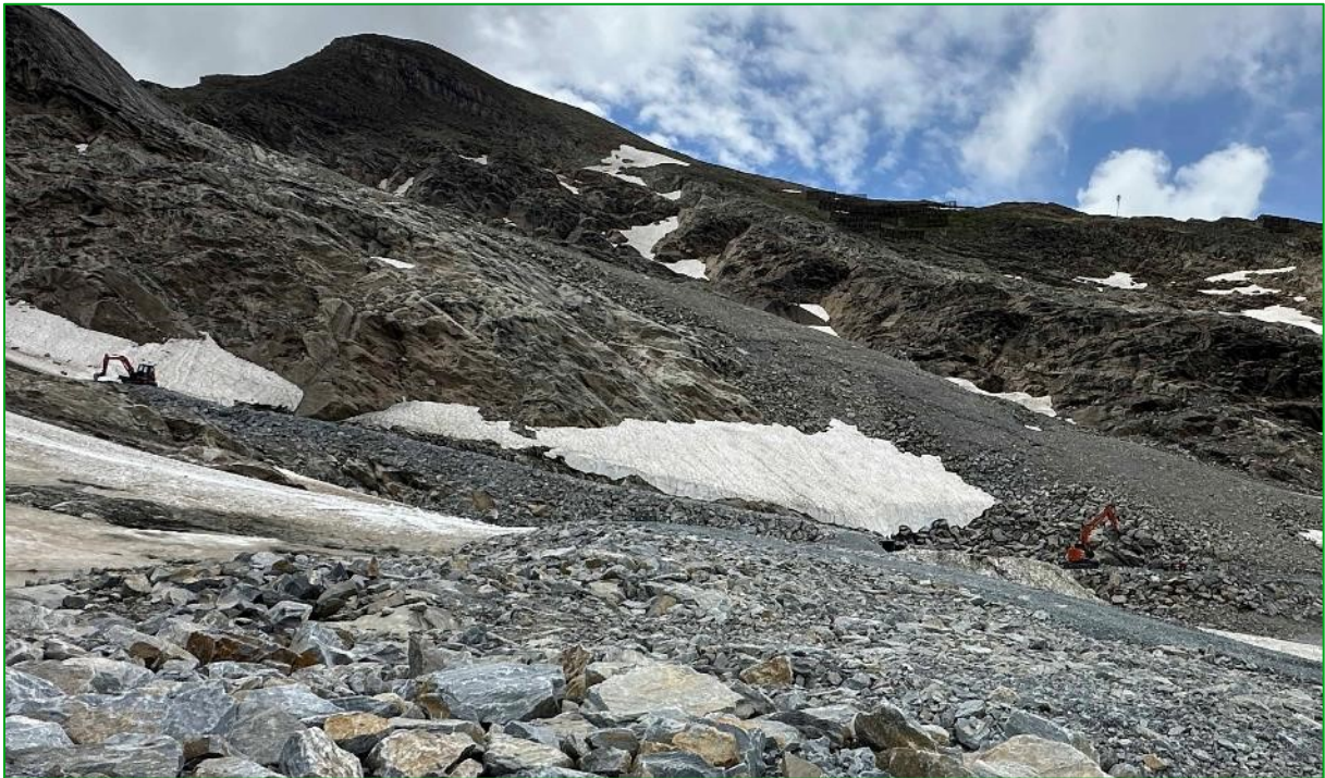
Bild 39: Arbeiten an der Feldleitung XVI der Beschneiungsanlage: Auch hier ist das Gelände nach Verfüllung der Künette mit heterogenen Felsschüttungen unter der Vermeidung gerader Kanten zu gestalten (01.08.2024).
